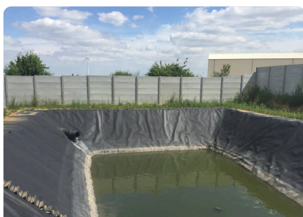
Bassin de régulation EP et confinement D9A
